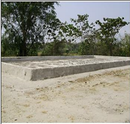
Foto 69. Dique en concreto, cluster Abarco AQ.
