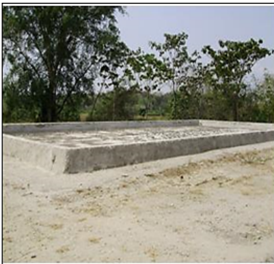
Foto 69. Dique en concreto, cluster Abarco AQ.
